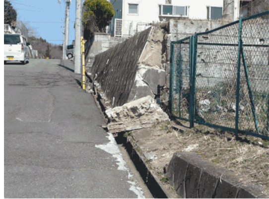
(b) 住宅地のコンクリートブロック倒壊 (北→南)
