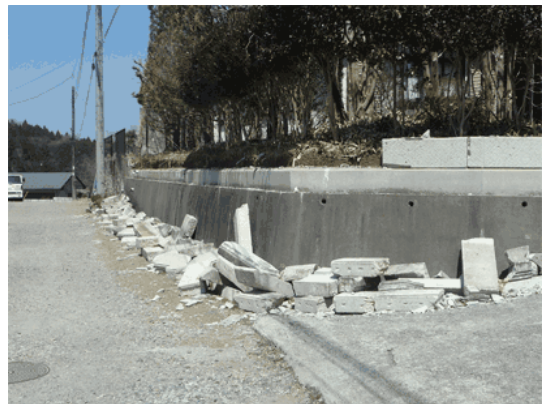
(d) ブロック塀の倒壊 (南東→北西)
