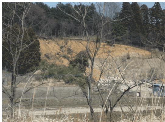
(f) 調査地域北側の住宅地近く斜面の崩壊 (南→北)
