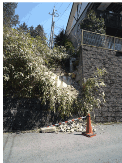
(l) 盛り土斜面の被害 (南→北)
