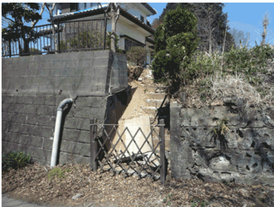
(e) ブロック塀の倒壊
