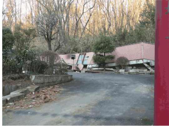
(b) 建物の倒壊（同左） （西→東）
