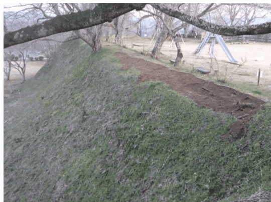
(f) 城山公園北側斜面滑り （西→東）
