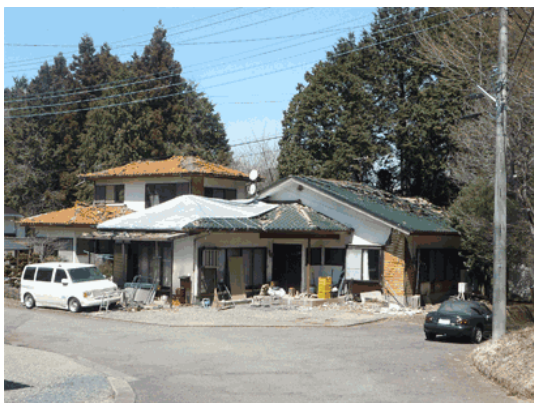
(k) 木造住宅の損傷 (南東→北西)
