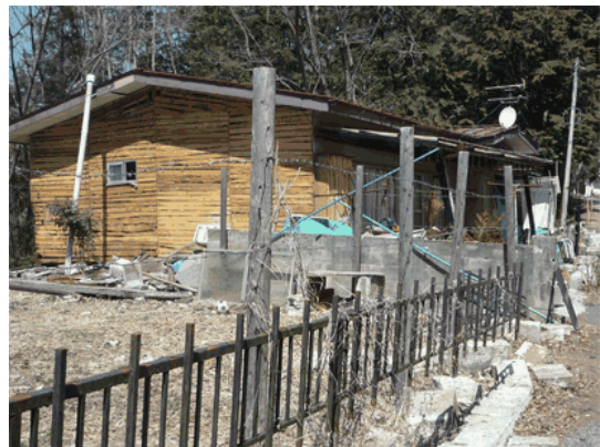
(j) 木造平屋の外装壁の剥落 (南西→北東)
