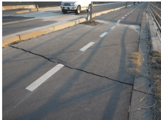
(d) ボックスカルバート背面の道路亀裂（市貝町） （北→南）
