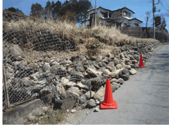
(b) 長峰公園西側路地の石積みの一部崩壊 (南西→北東)
