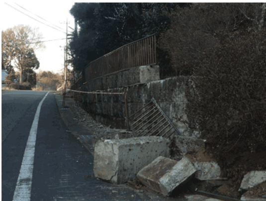
(c) 石塀の崩壊（芳賀町） （南→北）
