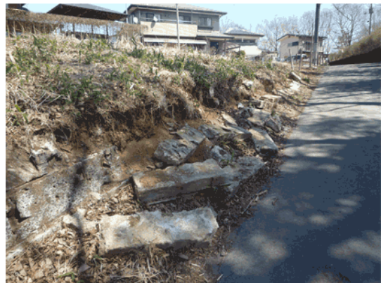
(f) 土留石ブロックの崩壊 (南西→北東)
