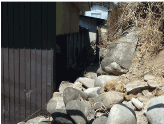
(c) 西側路地・石積み崩壊と家屋の被害 (南東→北西)
