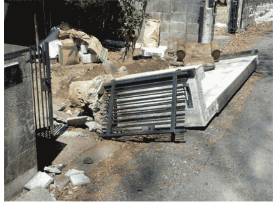
(h) コンクリート塀の転倒 (南東→北西)
